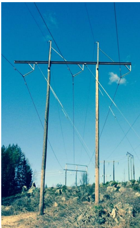
Figur 4.1. Aktuell kraftledning L4-70 är uppförd i träportal, tvåbent vinkel med topplinor. I bakgrunden syns trebent vinkel vid Ringnäs.
