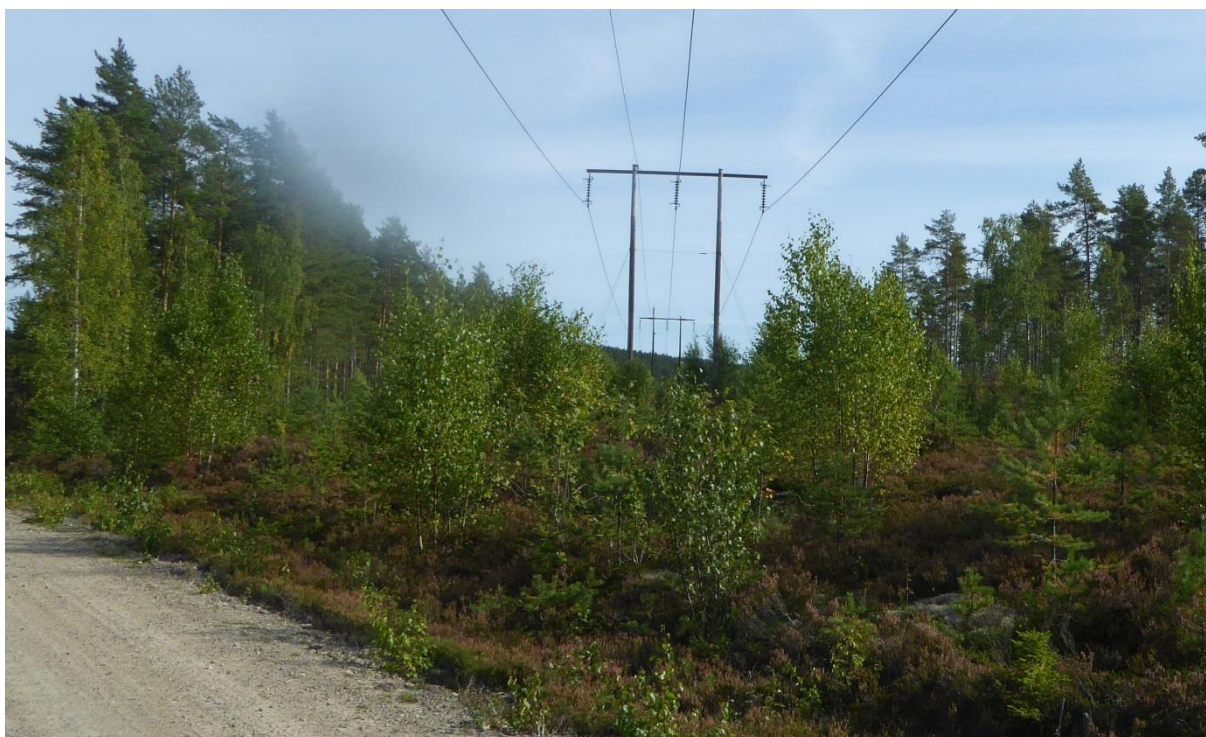
Figur 2. Stolpe nr.504 på sträckan Grycksbo-Stångtjärn. "Normalstolpe" på ledningen.
