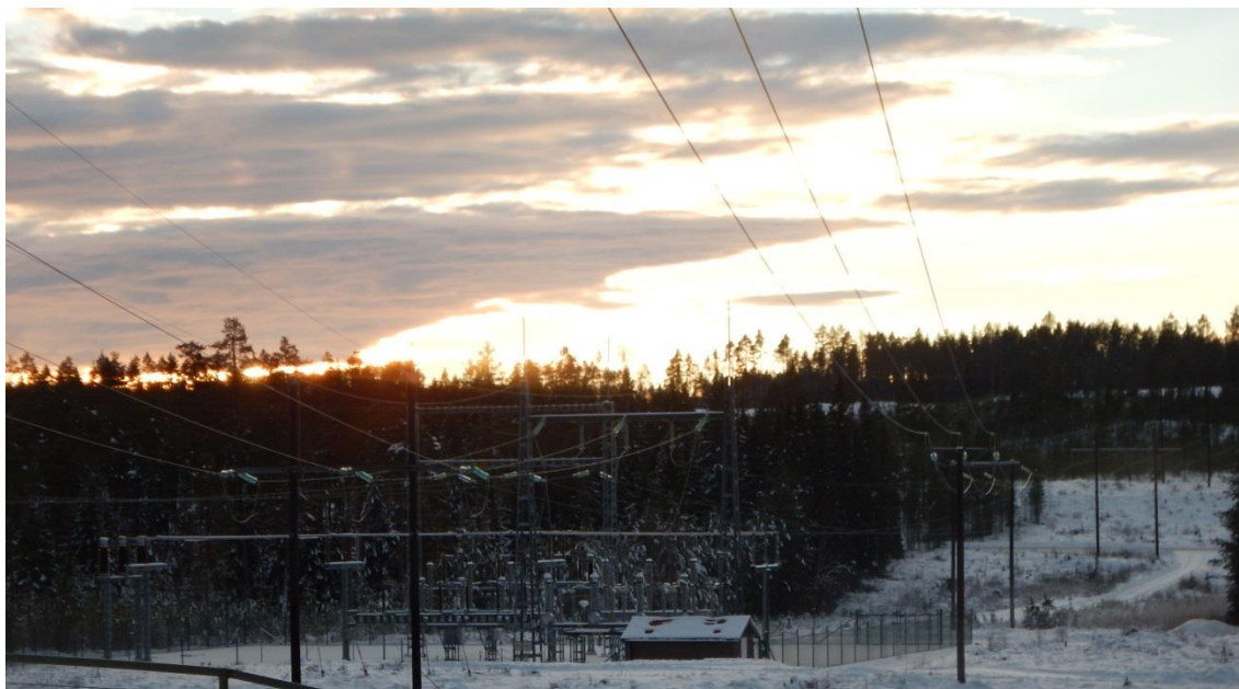
Figur 3. 50 kV ledning mellan Väsa och Blyberg går idag förbi ställverket på västra sidan om Österdalälven vid Blyberg. En ny 130/50 kV transformering planeras vid Blyberg. 50 kV ledningen kommer då ledas in i ställverket och bindas ihop med 130 kV-nätet.
