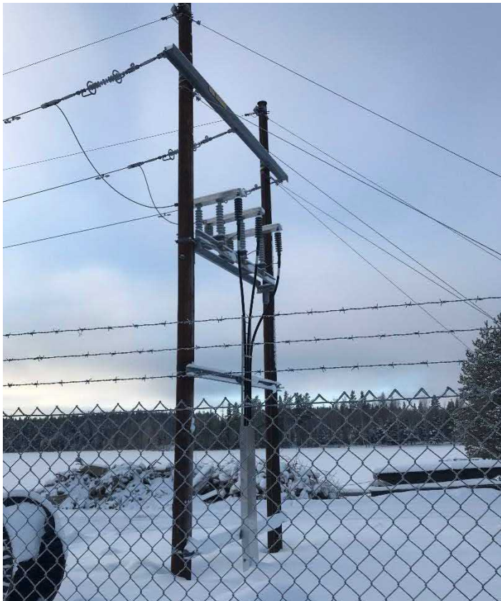
Figur 4. Exempel på en kabelstolpe.
