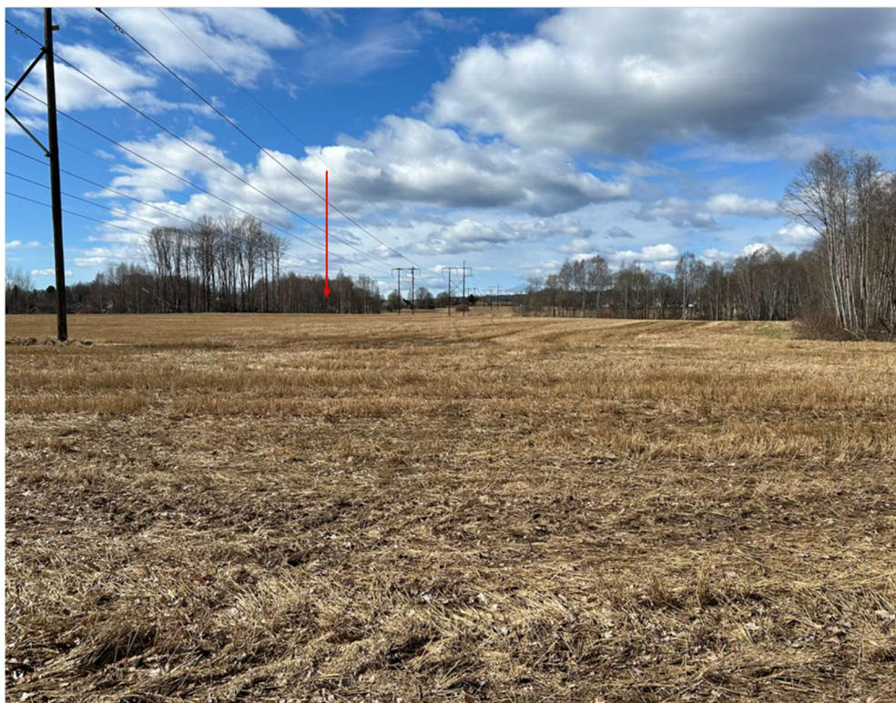
Figur 12. Fältet där markkabel övergår till luftledning väster om Dalälven. Alternativ 1a planeras att uppföras på den södra sidan av befintlig ledning (röd pil).
