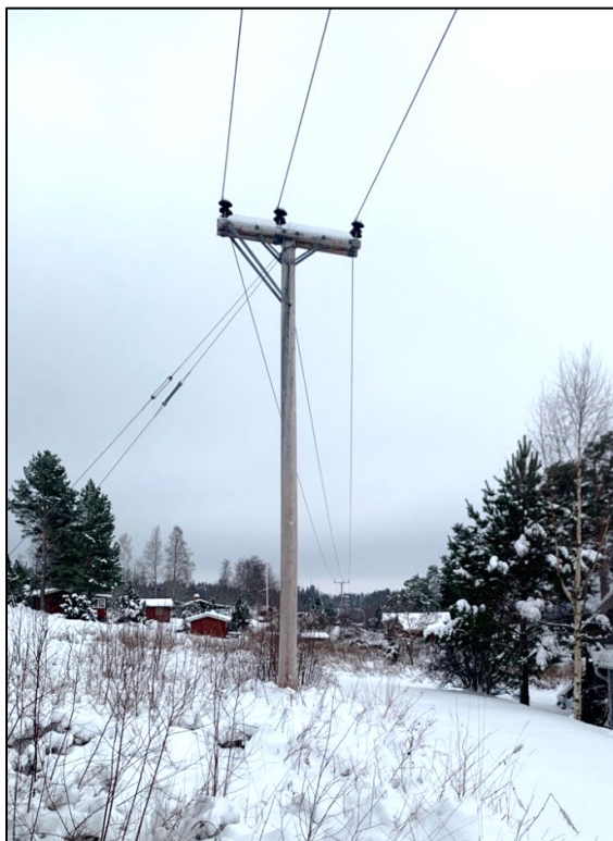
Figur 3. Enkelstolpe tillhörande AL12S1.
