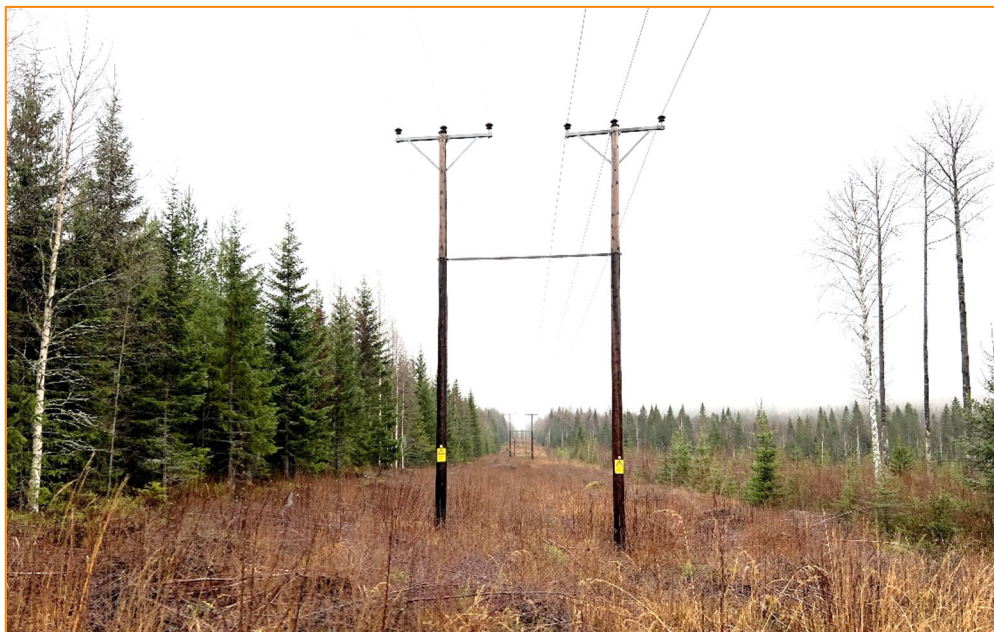
Figur 7. Befintliga 20 kV ledningar
