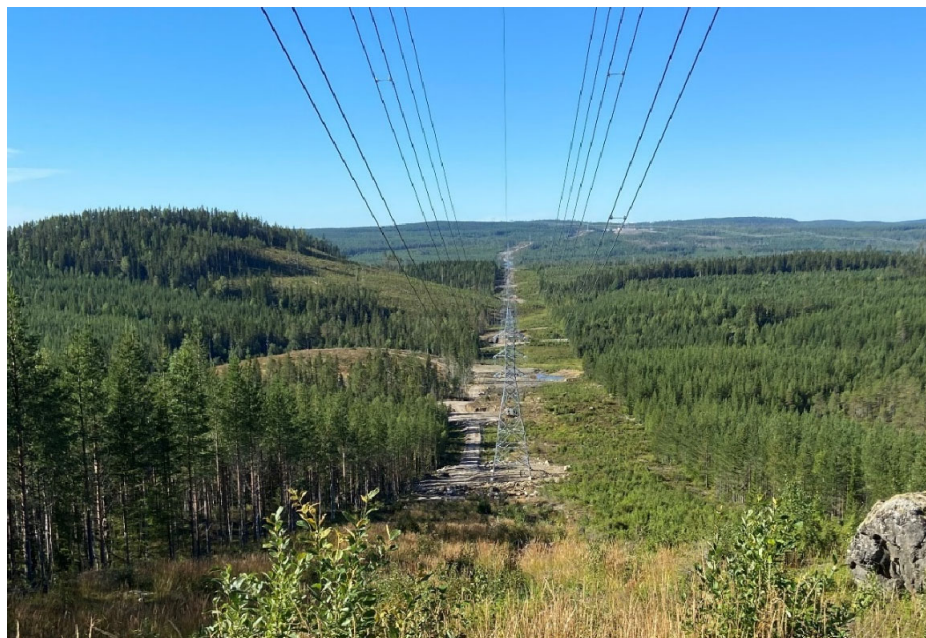
Figur 3. Dubbelledningen mellan Tovåsen och vindpark Björnberget. Foto taget mot station Tovåsen som kan anas i fjärran. Skogsgatan som syns i fotot är i nuläget bredare än vad som kommer behövas på sikt. Anledningen är att en befintlig 130 kV ledning var kvar och i drift väster om stålstolpsledningen (till höger i fotot) medan den nya ledningen byggdes. På detta foto är den gamla träportalsledningen raserad. Träd kommer att kunna växa upp i västra delen av skogsgatan så att dess bredd på sikt minskas.
