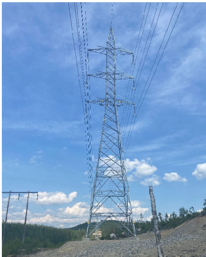
Figur 2. Stålstolpe på ledningen Tovåsen-vindpark Björnberget. Stolparna kommer bli 30-40 meter höga beroende på spannlängd och topografi. Observera att detta är en stolpe med duplex, (två ledare) medan aktuell ledning Alby-Tovåsen planeras med triplex (tre ledare).
