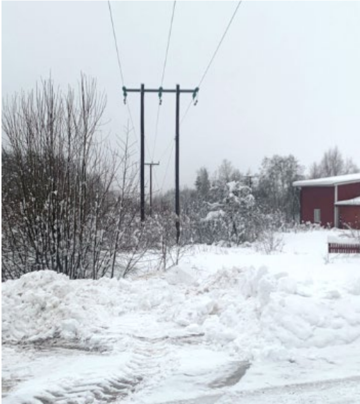
Figur 3. Exempel på portalstolpe tillhörande delen A11S1 av den aktuella ledningssträckningen.
