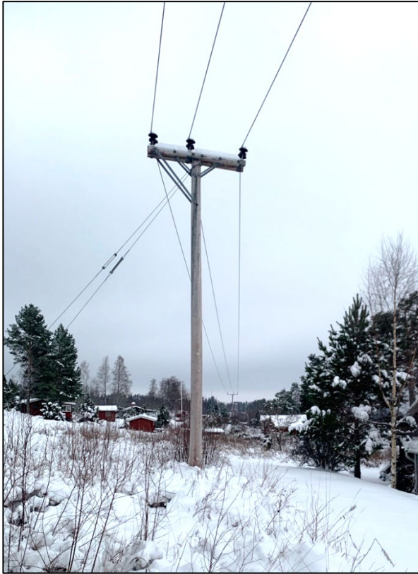
Figur 3. Enkelstolpe tillhörande AL12S1.
